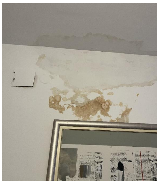
Слика 5. Објект Стари Завод (Сокоград), ходник на зиду између две собе, која показује цурење из купатила на спрату изнад, услед чега је соба затворена и не користи се до даљег
